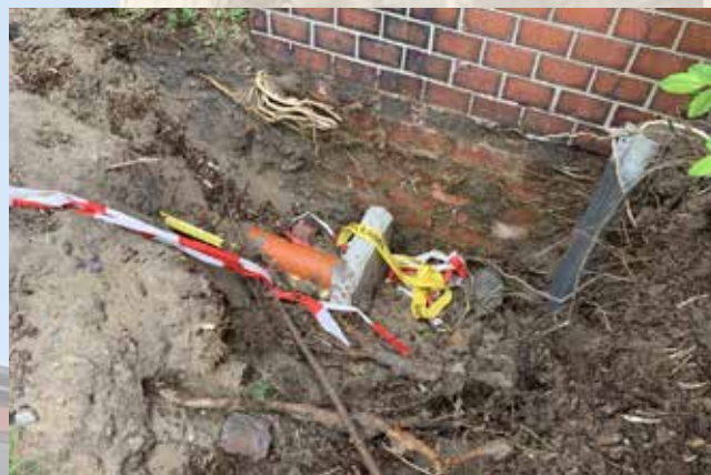
St. Paulus: Anschluss für E-Ladestation
